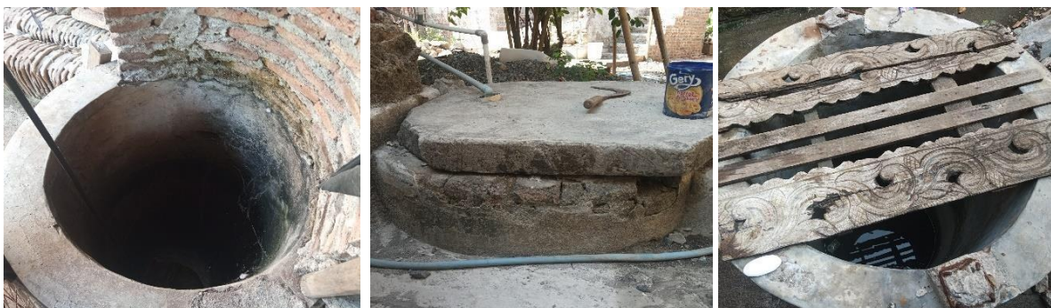
Gambar 6.1 Sumur warga yang tidak dipakai karena kualitas air dan kering
